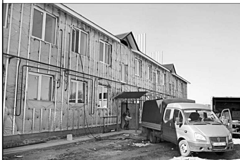
В новом восьмиквартирном доме, построенном по федеральной программе, полным ходом идут отделочные работы.
